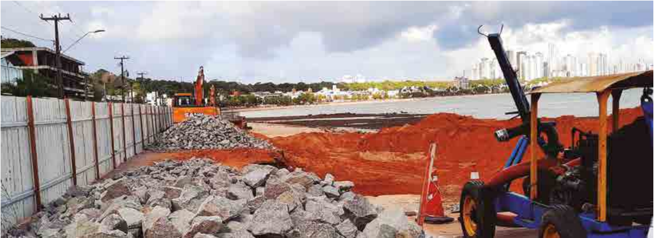
Primeira etapa das obras prevê a construção dos gabiões ao longo de 520 metros no trecho final da Praia do Cabo Branco; nessa área, a calçadinha, a ciclovia e parte da pista foram destruídas devido à ação do avanço do mar
